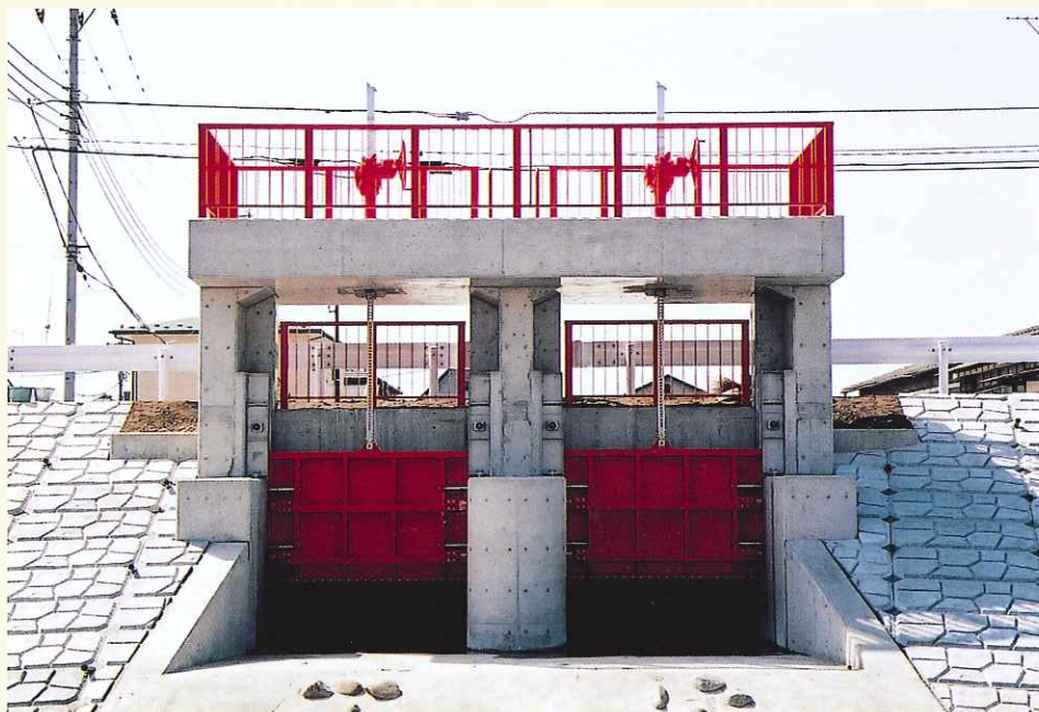
鋼製ローラーゲート（ラック式）4方水密式 W2350×H1500×2門 鹿沼市貝島町
